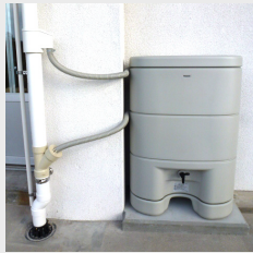
⑥ 雨水タンク
