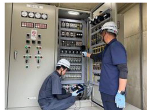
第 1 水源地電気設備の点検の様子
