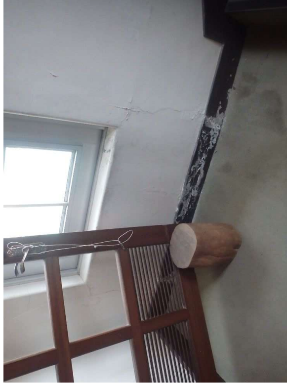
写真⑥2階壁 X-X4 ・Y-Y1～Y2 、c-1 漏水跡
