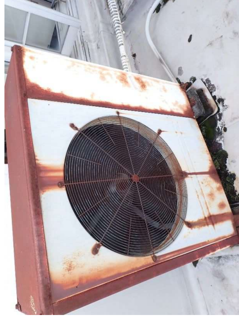
室外機①の接写
