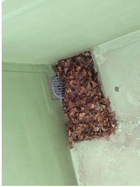
屋上ドレン: 落葉つまり
