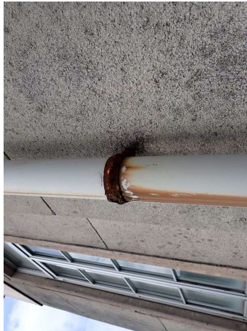
樋支持金物: 錆
