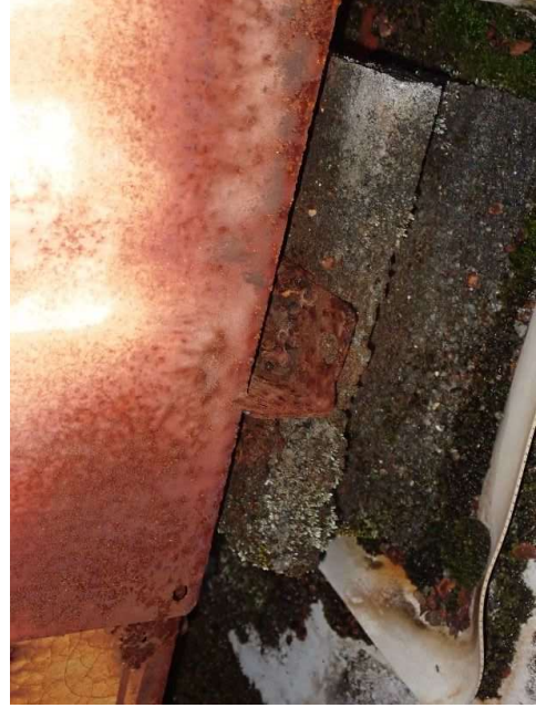
室外機②の接写
