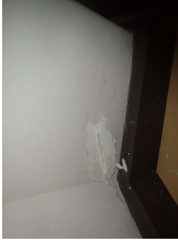
写真⑤1階柱 X-X4 ・Y-Y6 、c-2 仕上材の剥落
