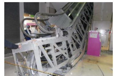
【エスカレーター落下】 （写真：国土交通省）
