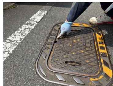
〈平町通り消火栓〉
