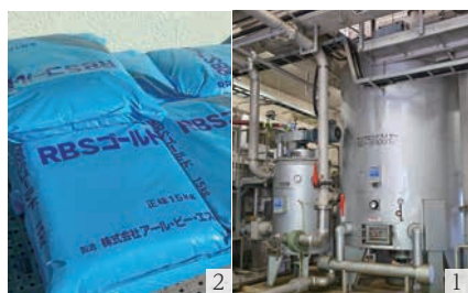
1_ 自然浄化処理工程で生成した微生物を分離、脱水し、蒸気乾燥させる 2_ 乾燥させた有機肥料は、袋詰めして販売
