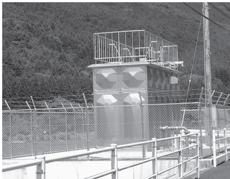
新設された市水道中継タンク（中鶴）
