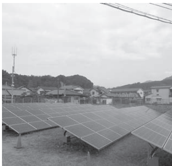
太陽光パネル
