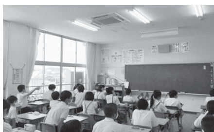
昨年度全小中学校普通教室に設置されたエアコン
