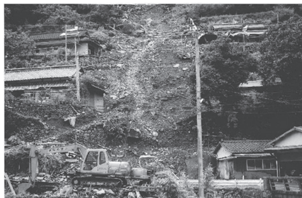
深川新屋敷地区土砂災害近景
