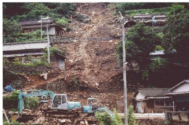
深川新屋敷地区土砂災害近景
