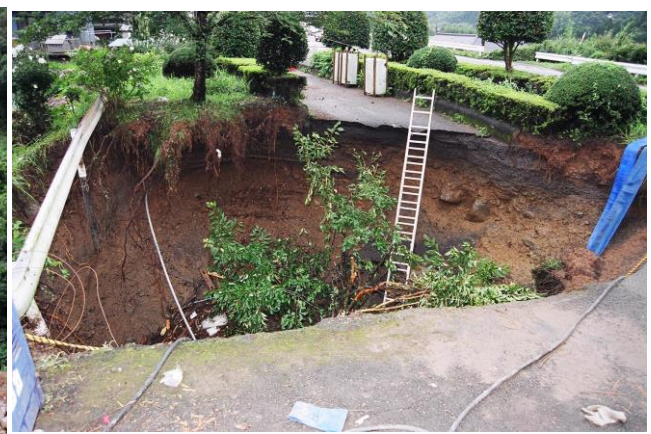
写真 道路や歩道の陥没も多数発生した
