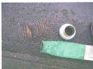
ホースの破損を発見した。
