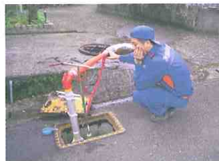
消防水利への補水。
