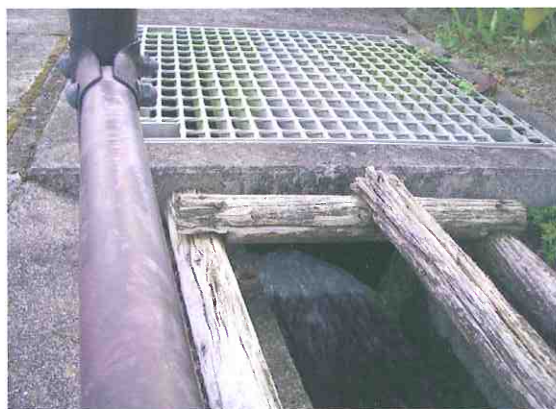
農業用水の暗渠 子供が転落する恐れがある。 暗渠の深さは1.5m
