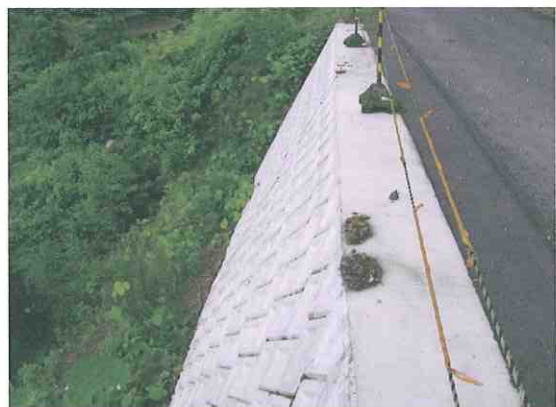
宝川内道路 トラロープを張ってあるが固定されていない。
