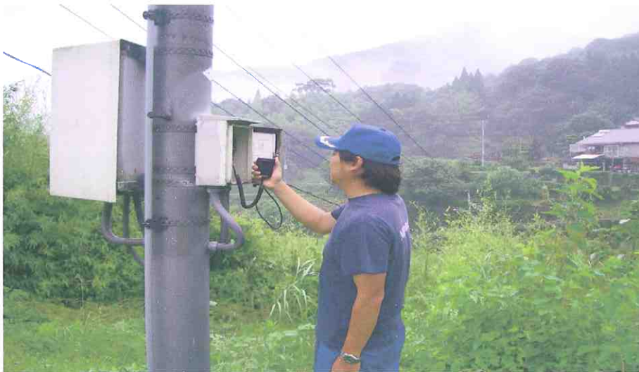
防災無線機器の点検中
